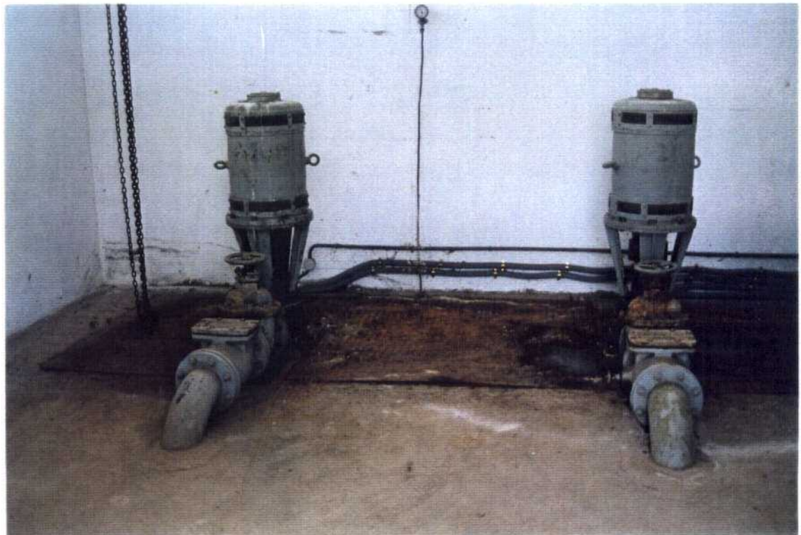
INSTALACION DE BOMBEO EN LOS POZOS DE SOTO CASTILLUELOS
